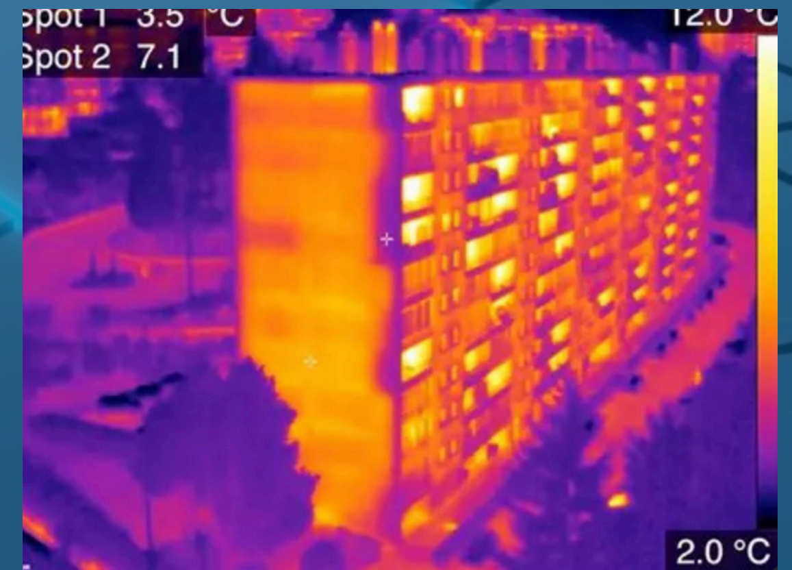
Défaut isolement thermique bâtiment
