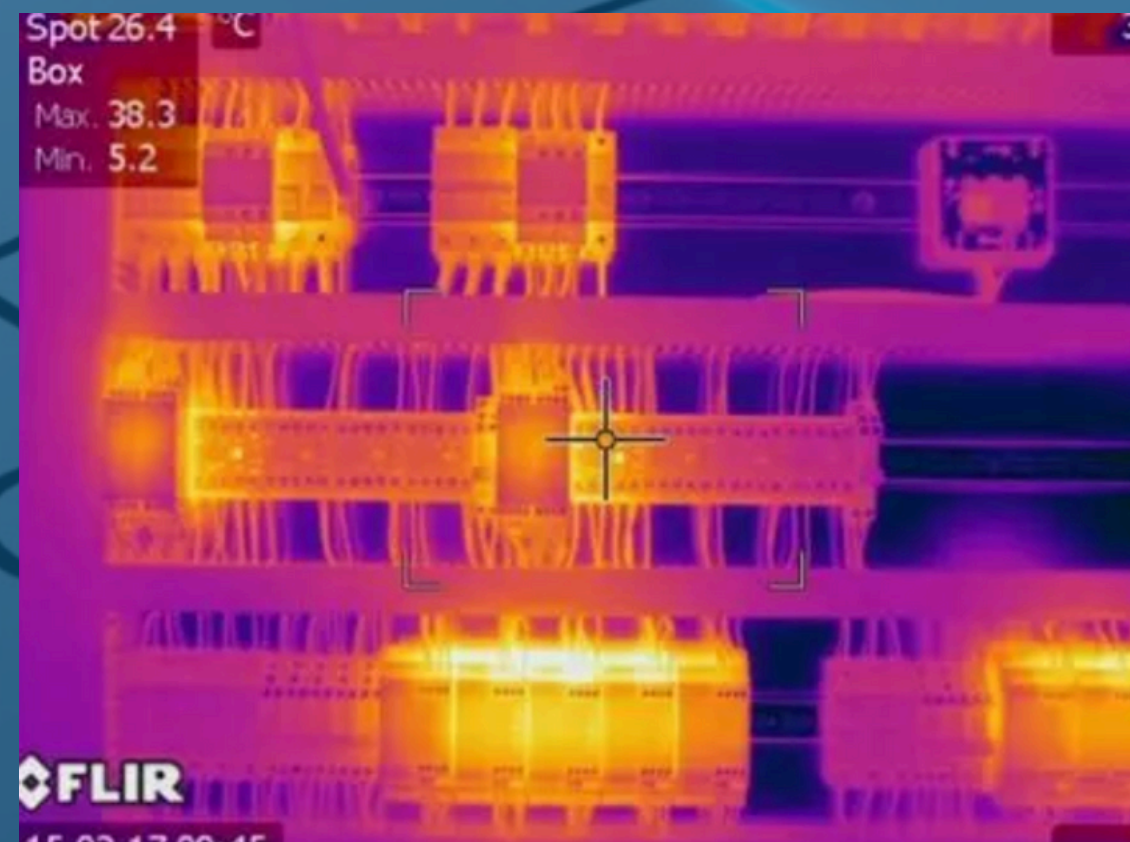
Echauffement thermique Tableau Electrique
